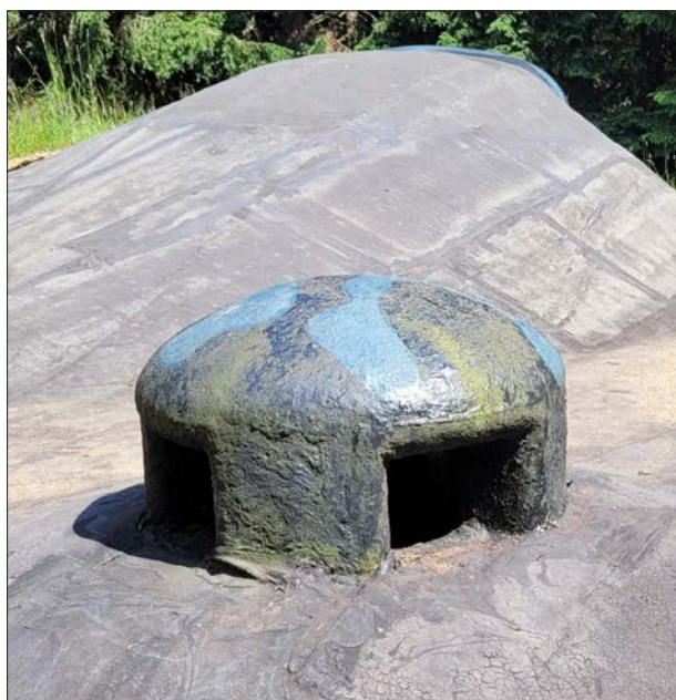
Ventilační zvon středního typu, zachovalý na střeše pěchotního srubu R-S 77 tvrže Hanička. Při přestavbě tvrže na objekt KAHAN byl zvon zaizolován a zahrnut zeminou. (2023, LČ)
