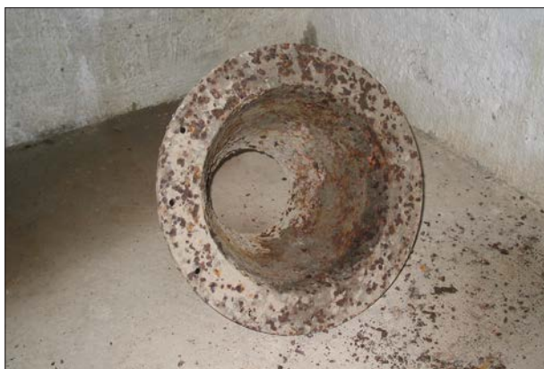
Spodní, rozšířená část potrubí s přírubou z ventilačního zvonu z objektu K-S 23 tvrže Bouda. (2002, LČ)
