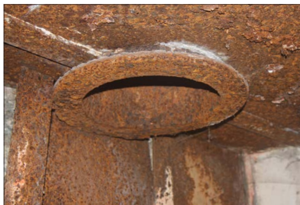
Příruba na konci potrubí sacího ventilačního zvonu v objektu K-S 10 tvrže Hůrka. (2016, LČ)
