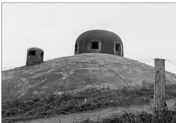
Ventilační zvon malého typu určený pro nasávání vzduchu pro pozorovatelnu MO-S 42 tvrže Smolkov. (1938, LČ)
