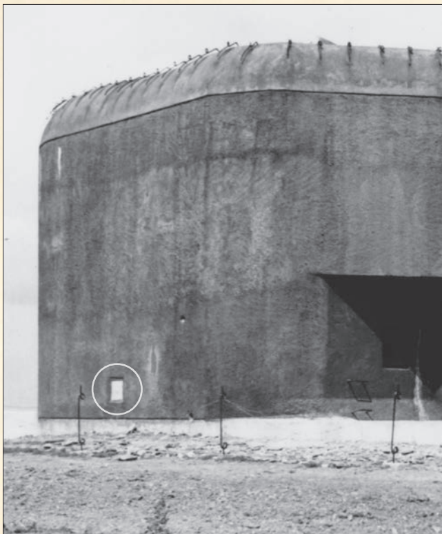
Otvor nasávacího kanálu vzduchu v zadní stěně pěchotního sruhu N-S 72 tvrže Dobrošov byl umístěn velmi nízko nad terénem. Vpravo je vyústění granátového skluzu a otvor pro periskop. (LČ)
