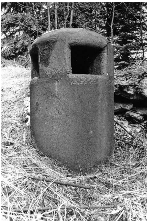
Obnažený ventilační zvon středního typu v pýchotním srubu R-S 80 tvrže Hanička. Dobře je vidět poškození zvonu způsobené německým odstřelováním objektu. (80. léta 20. století, OG)
