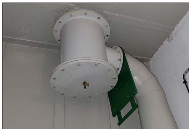
Propojení potrubí vnitřního rozvodu s potrubím sacího zvonu přes „T“ kus v objektu K-S 22 tvrže Bouda. (2023, LČ)
