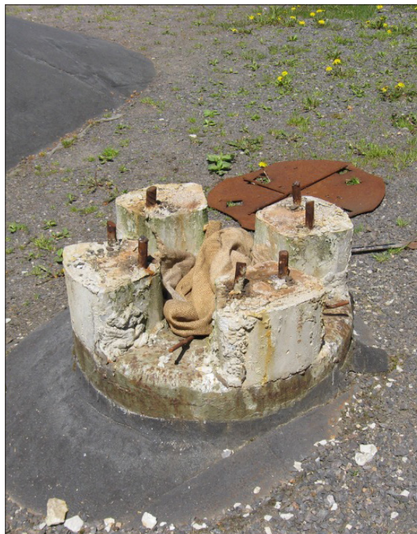
Ani pokus o dobetonování chybějícího vrchlíku znovu objektu R-S 78 na Haničce nedopadl úplně nejlépe. (2006, FB)
