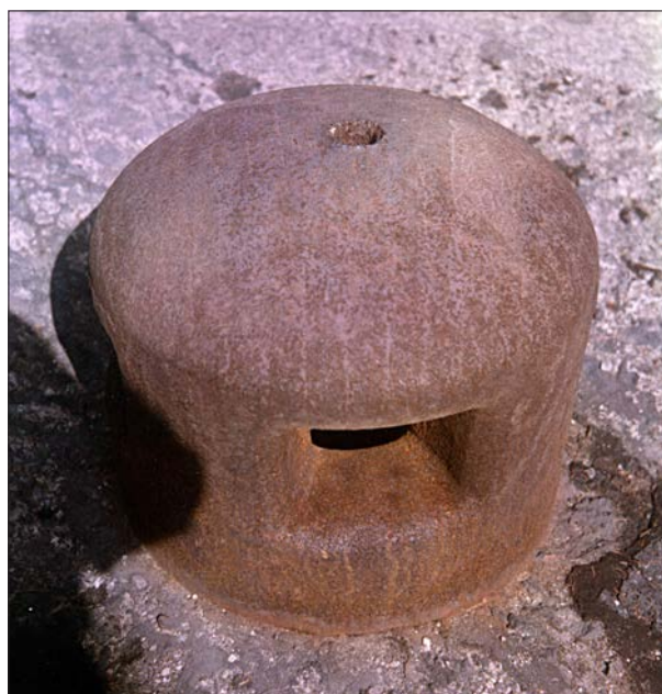
Sací ventilační zvon objektu K-S 42 tvrže Adam má ve vrchlíku průpal, pravděpodobně od kumulativní nálože. Zda-li byla nálož odpálena Němci nebo československými ženisty po válce není jisté, spíše se ale jedná o poválečný odpad. (AH)
