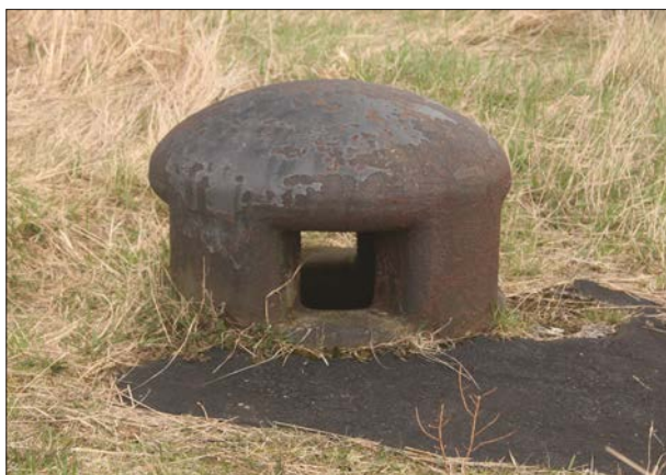
Střední typ ventilačního zvonu zachovalý na stropě pěchotního srubu K-S 10 tvrže Hůrka. (2012, LČ)
