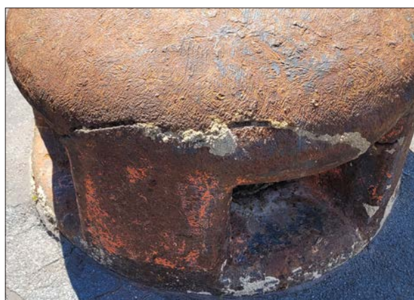
Detail praskliny vrchlíku téhož ventilačního zvonu – nahore na fotografii z roku 1986 (TS), dole stav zvonu v roce 2023 (LC).
