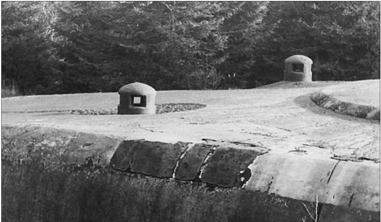
Ventilační zvony na střeše objektu K-S 42 tvrže Adam. Na fotografii je dobře patrné, že sací zvon je zapuštěn pod úroveň horní hrany stropní desky (trychtýřovitý prostor okolo zvonu včetně odvodňovací drážky byl zřejmě upraven až po betonáži objektu), naopak evakuační zvon je vyvýšen. (IF)
