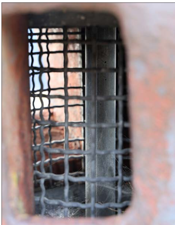
Detail ochranného mřížového koše ventilačního zvonu, za kterým je dobře vidět potrubí odvětrávající záchody; tvrz Rimplas (2024, Jean-Michel Jolas, wikimaginot.eu, CC BY-NC 4.0).
