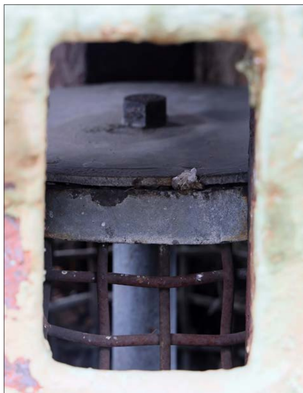
Detail vrchní části ochranného mřížového koše ventilačního zvonu, koš s potrubím je částečně spuštěn ze správné polohy; tvrz Mont Agel (2024, Jean-Michel Jolas, wikimaginot.eu, CC BY-NC 4.0)
