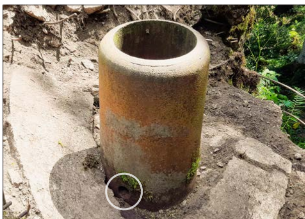
Ocelové potrubí, které zůstalo ve stropní desce pěchotního srubu K-S 21 na tvrzi Bouda po vytržení ventilačního zvonu. V dolní části je dobře patrný otvor pro jeden z trojice šroubů, kterými bylo potrubí uchyceno ke zvonu. (2024, LT)
